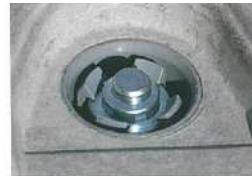
No.9 ホルダーの爪がアンカー 頭部にかかるまで打ち込む
